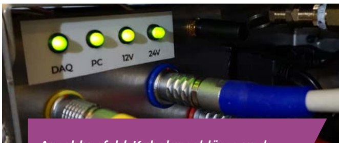
Anschlussfeld, Kabelanschlüsse und Anzeige-LEDs im Inneren des Gehäuses
